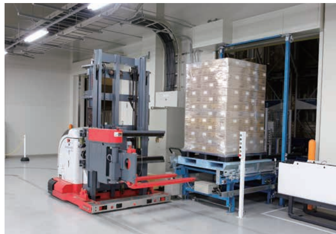
・自動倉庫入出庫装置までの搬送を自動化する「ラックフォークオート」
